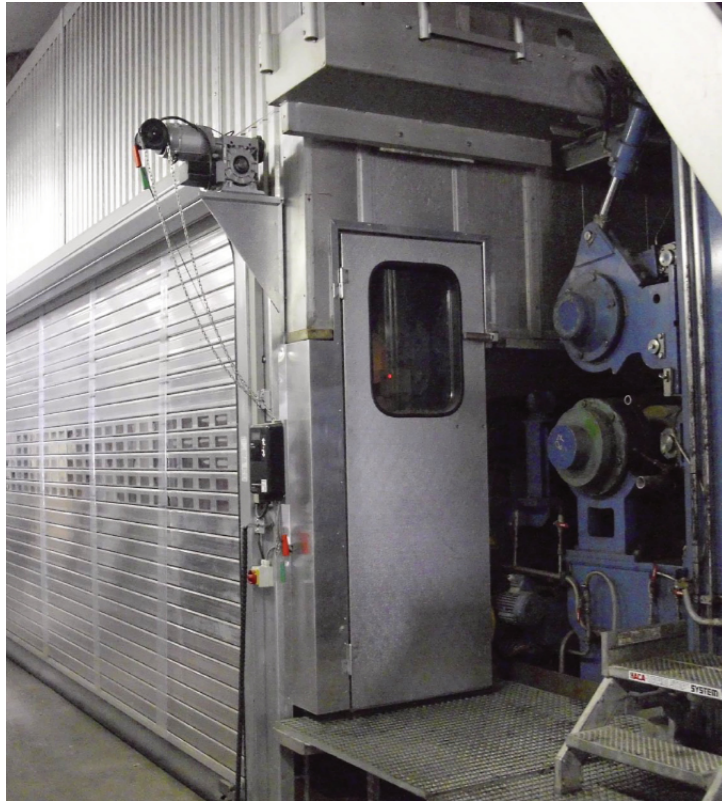
Kartonmaschine mit Wärmerückgewinnungshaube
