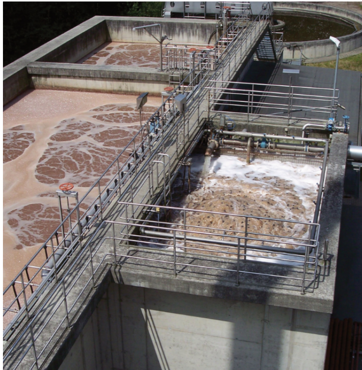
Biologische Abwasserbehandlung, Belebungsbecken
